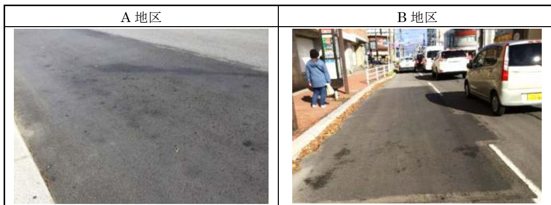
写真-4 2017年11月に調査した路面状況
