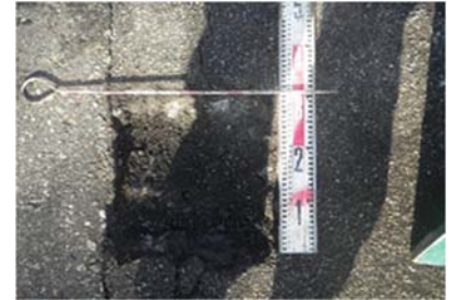
写真-5 擬似ポットホール
