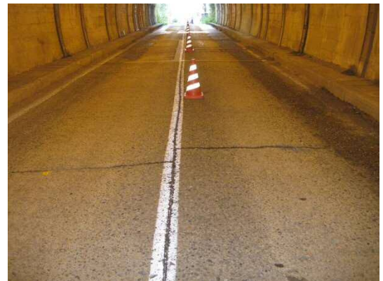
写真-1 既設 Co の収縮ひび割れ
