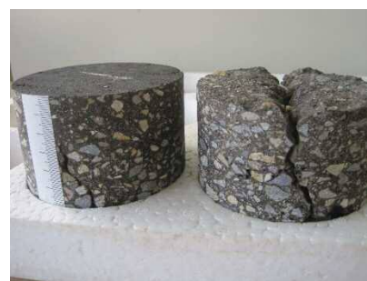
写真-7 施工前後のひび割れ断面
