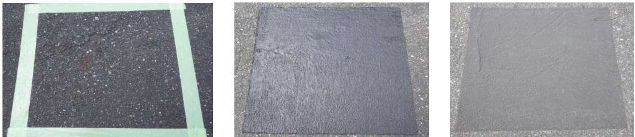
写真-3 目視による路面状態の追跡調査 (左から、施工前、施工直後、施工1年後)
