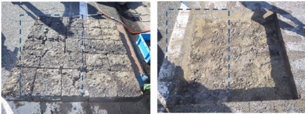
写真-4 上層路盤下面と下層路盤上面の界面の付着状況
