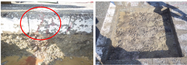
写真-3 アスコン層の開削断面と下層路盤上面のひび割れ状況
