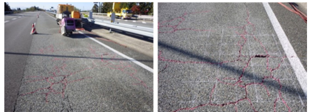
写真-1 調査箇所の舗装表面のひび割れ状況
