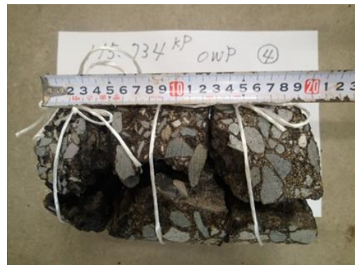
コア断面(ひび割れあり: 損傷箇所-2)
