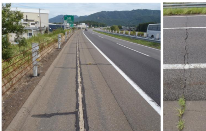
写真-1 横断ひび割れの発生状況
