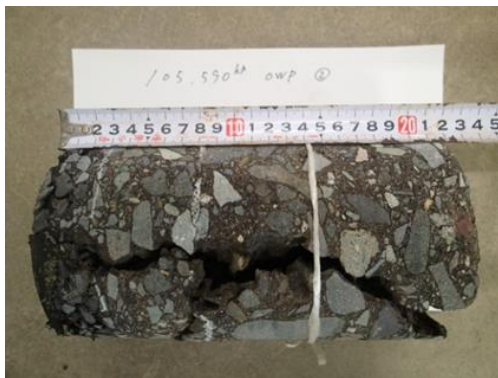
コア断面(ひび割れあり: 損傷箇所-1)
