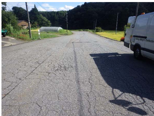
写真-2 現場Cの路面状況
