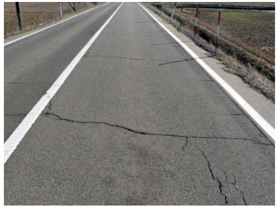
写真-1 サーマルクラック
