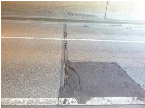
写真－2 欠損部①
