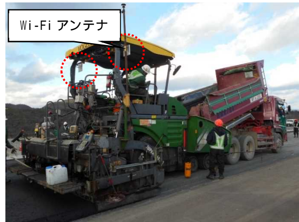
写真 - 3 Wi-Fi 環境構築状況
