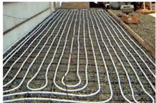
図-4 ロードヒーティング
