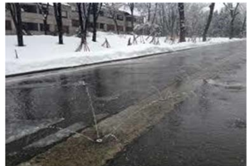
図-3 消雪パイプ
