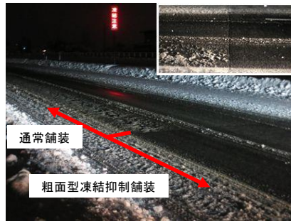
写真-10 2 冬目の路面状況
