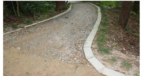
写真-1 破損した土系舗装
