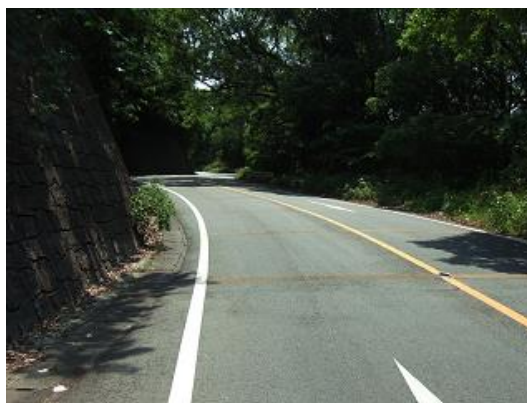
写真-5 施工3年9ヵ月後状況
